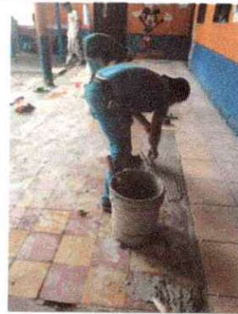
Foto 8. Se observa la puerta el pegado del piso antideslizante
